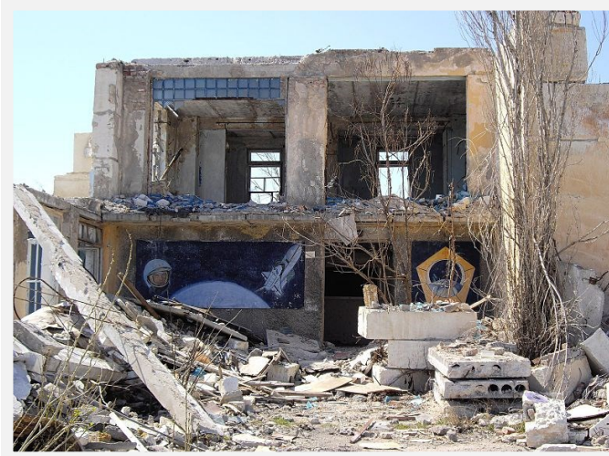
Częściowo zniszczony budynek na terytorium NPP-10.
