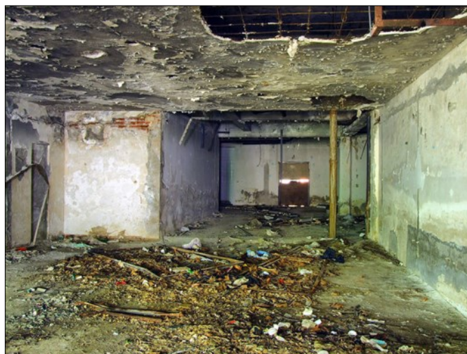
Zniszczony hotel. Fot. M. Szala
