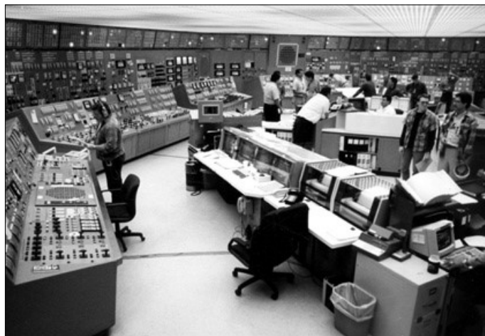
Pokój kontrolny w amerykańskiej elektrowni atomowej.
