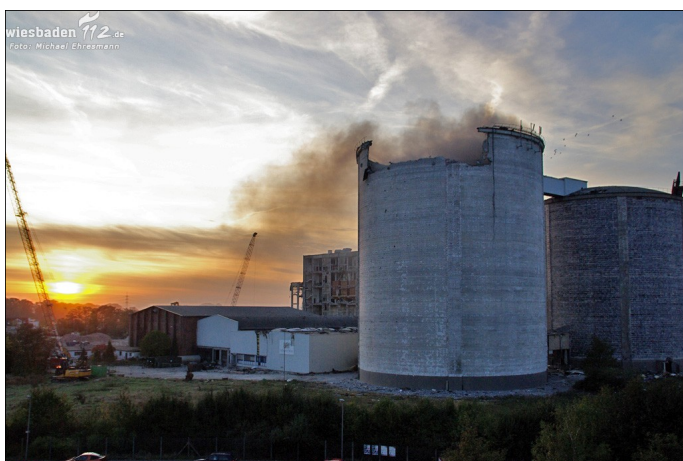
Uszkodzony wybuchem pyłu silos cukrowni w Niemczech.
