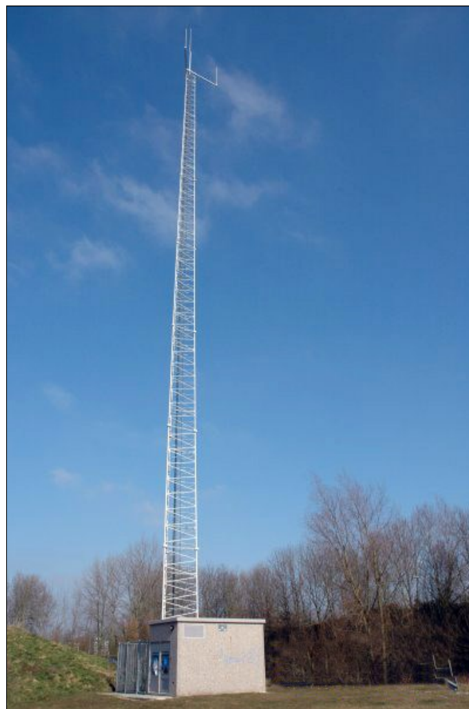
Widoczna na fotografii stacja jest częścią holenderskiej sieci radiowej bezpieczeństwa publicznego C2000, pracującej w systemie TETRA. Fot. Wilbert van de Kolk, commons.wikimedia.org
